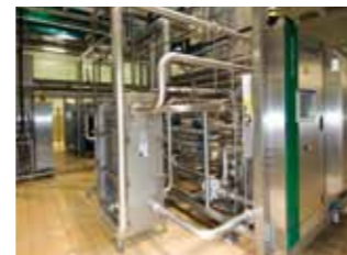
Die neue Kurzzeiterhitzungsanlage VarioFlash B von KRONES.
